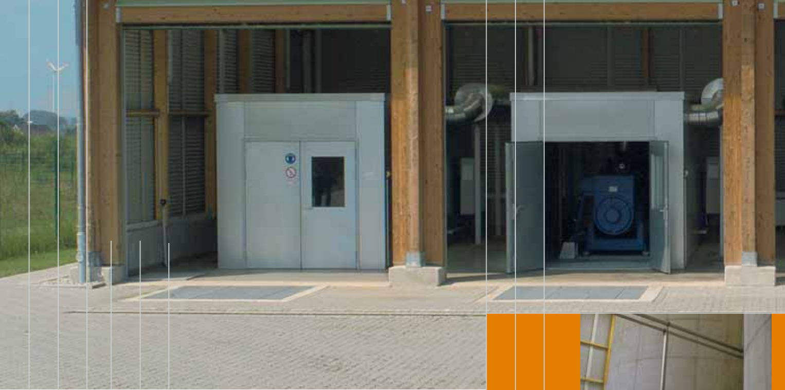
BHKW-Anlage auf einer Deponie
